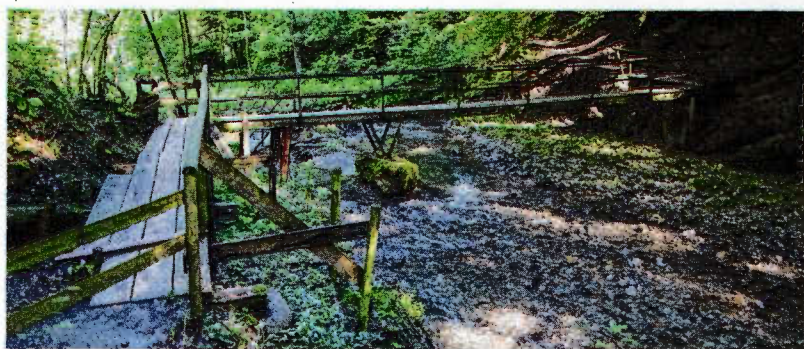
Verlegt die Gemeinde den Weg auf die rechte Uferseite, könnte diese Brücke wegfallen. Der Hang links ist in Bewegung. Das sieht man auch an den Gabionen unterhalb des Stegs, die inzwischen stark verformt sind.
