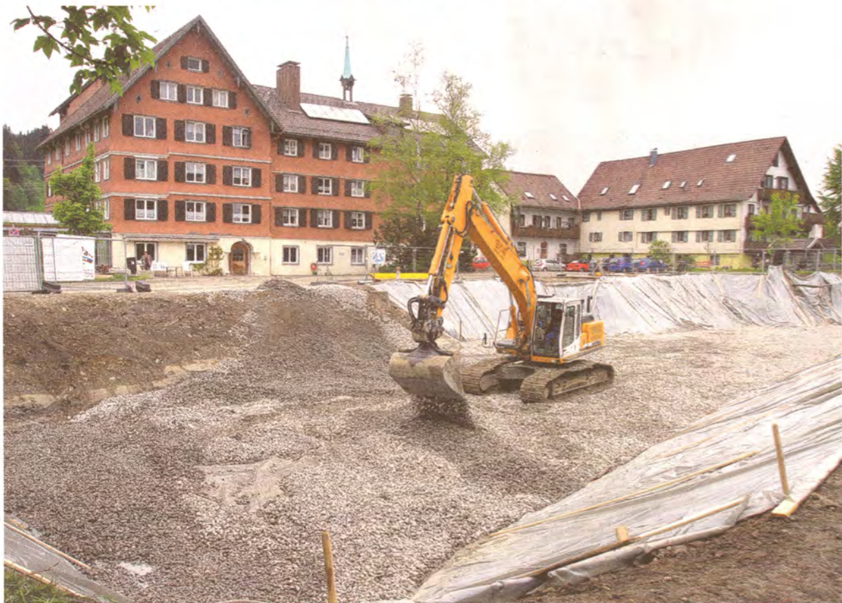
Die Baugrube ist ausgehoben, die Bagger an der Arbeit. Neben dem Seniorenheim Rothach in Weiler entsteht eine Seniorenwohnanlage. Foto: Matthias Becker
