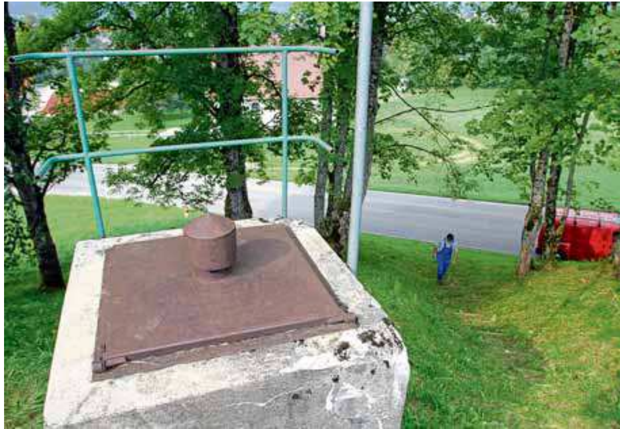
Der Hochbehälter ist nahe der Schule in Weiler im Boden vergraben. Er ist über eine Luke zugänglich – und die sei nun ungenügend gesichert, bemängelt das Ingenieurbüro AGP nach seinen Untersuchungen. Foto: Matthias Becker
